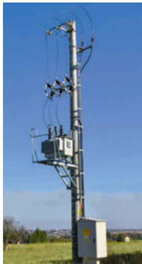
SŁUPOWE STACJE TRANSFORMATOROWE
