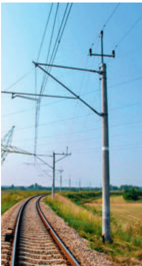
SŁUPY TRAKCJI KOLEJOWEJ ETG
